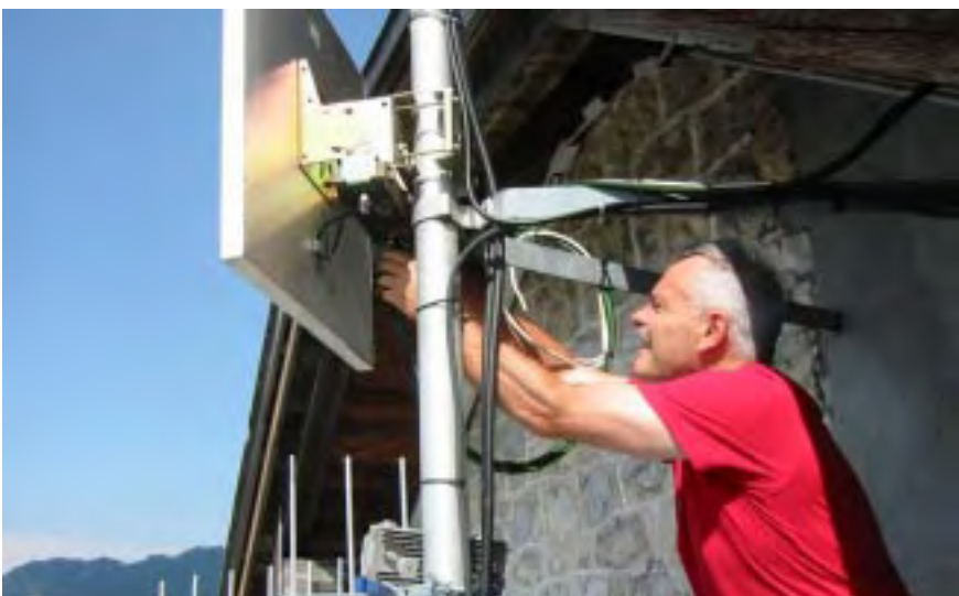
Ernst HB9MNP bei der Installation des Links zum Bachtel
